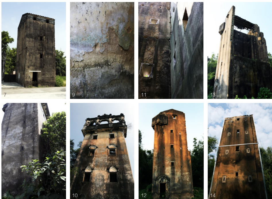
7 瓦下村村前夯土碉楼 9 夯土墙起壳剥落 11 墙角处竖向通长裂缝及雨水冲蚀内墙 13 夯土墙坍塌 8 瓦下村村后夯土碉楼 10 公安楼 12 网山村夯土碉楼 14 用钢带和角钢加固的夯土墙
